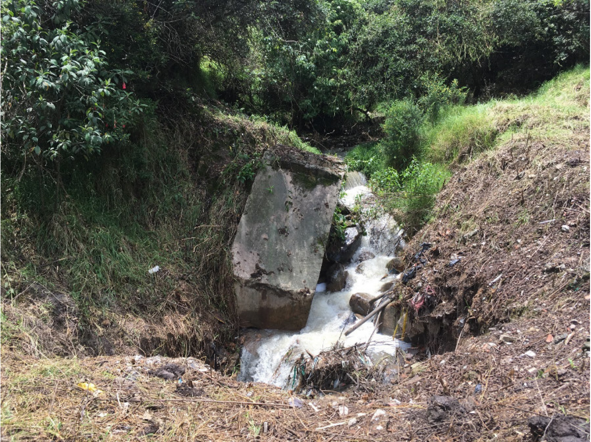
Fotografía 1. Punto de intervención del cauce de la quebrada Vitelma. Se evidencia una estructura existente que presentó daños como resultado de un evento de remoción en masa sucedido hace aproximadamente dos años, según información proporcionada por la EAB E.S.P.
