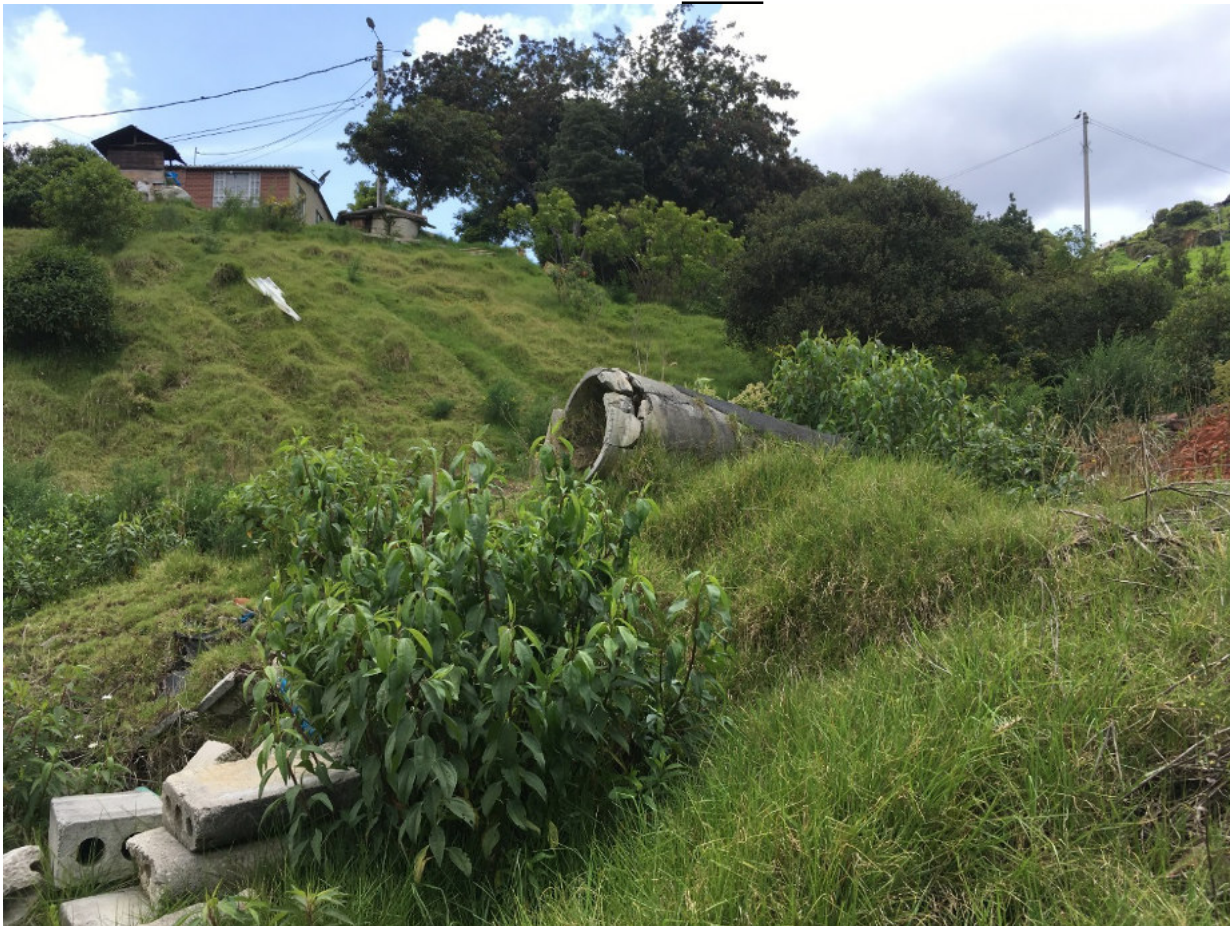
Fotografía 8. Corredor Ecológico de Ronda de la quebrada Vitelma, en donde se proyecta la instalación de la cámara de inspección del pozo No. 2. Se evidencia el acopio de material de construcción además de una tubería en asbesto cemento en estado de deterioro.
